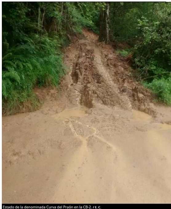
Estado de la denominada Curva del Praón en la CB-2. / E. C.
